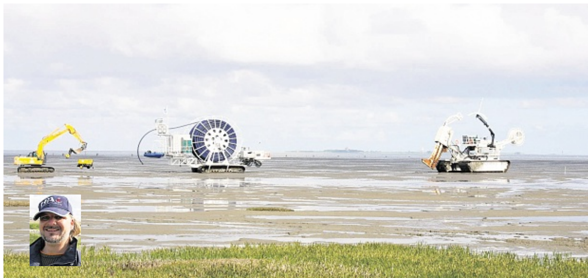
„Nessie III“ heißt die Watträse (r.) mit der das Polyethylen-Rohr vier Meter tief in den Wattboden verlegt wird. Um Beschädigungen am Rohr sofort zu entdecken, wird es mit einem Kompressor unter Druck gesetzt. Jörg Fischer (kl.F.) organisiert die Arbeiten für HP-A. Fotos: Sassen
